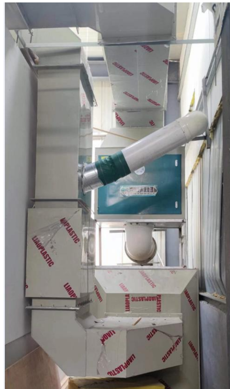
图 2 废气治理设施
